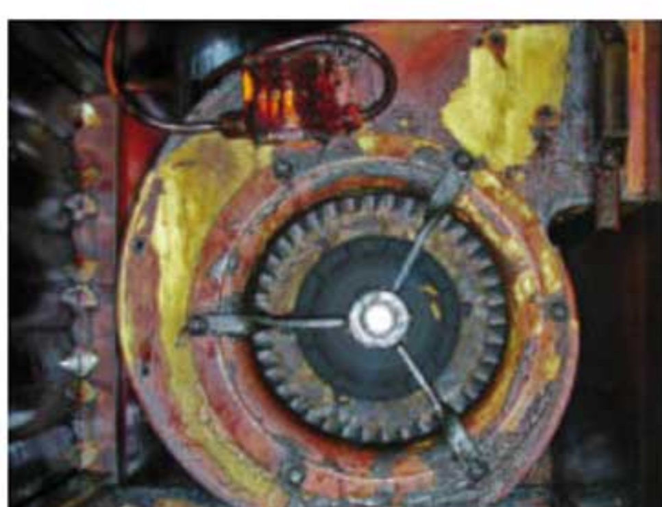
Motor de ventilador peligroso
